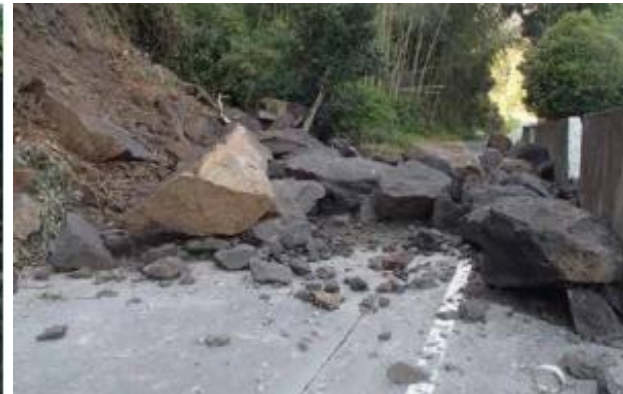
▲ 一般県道玉名植木線 法面の崩壊
