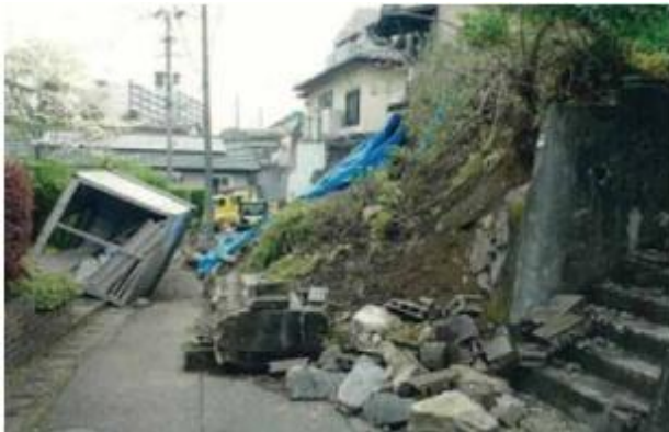
▲ 宅地擁壁の被災状況
