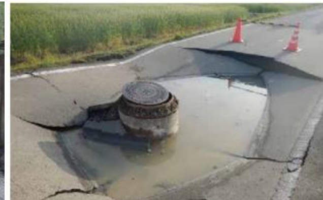
▲ 下水道(管路)の被災状況
